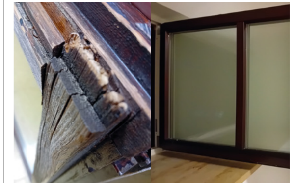
Alter, angefaulter Fensterstock(links), neues Fenster (rechts). Bei den, vom Umbau der Fenster betroffenen Räumen handelte es sich ausnahmslos überwiegend um Beherbergungszimmer für jugendliche Gäste und zum kleinen Teil um Büro- und Seminarräume.
